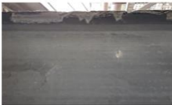
Figura 2d: rotura desalineamiento
